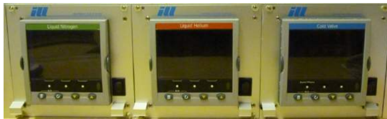
FIGURE 8.12.3 – Modules Eurotherm servant pour la mesure des niveaux d'azote (à gauche) et d'hélium (au centre) et la régulation de la vanne froide (à droite)
