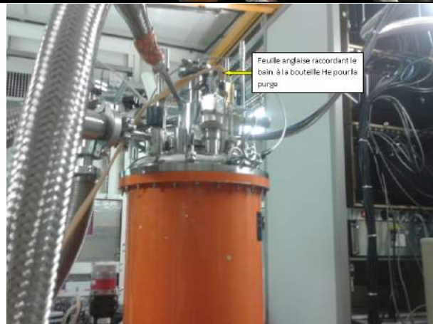
FIGURE 8.12.8 – Connexions à réaliser (figures du haut : en fonctionnement normal ; figure du bas : pour la purge)
